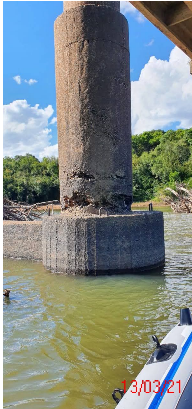
Figura 113 - armadura exposta no apoio P4
