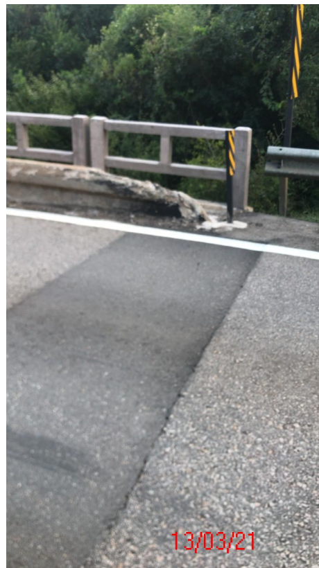
Figura 134 - não identificadas juntas de dilatação na faixa de rolamento - encontro
