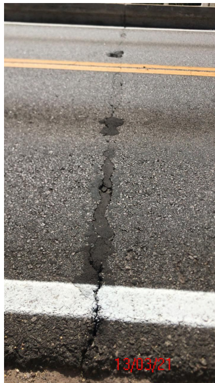
Figura 136 - não identificadas juntas de dilatação na faixa de rolamento - apoios centrais
