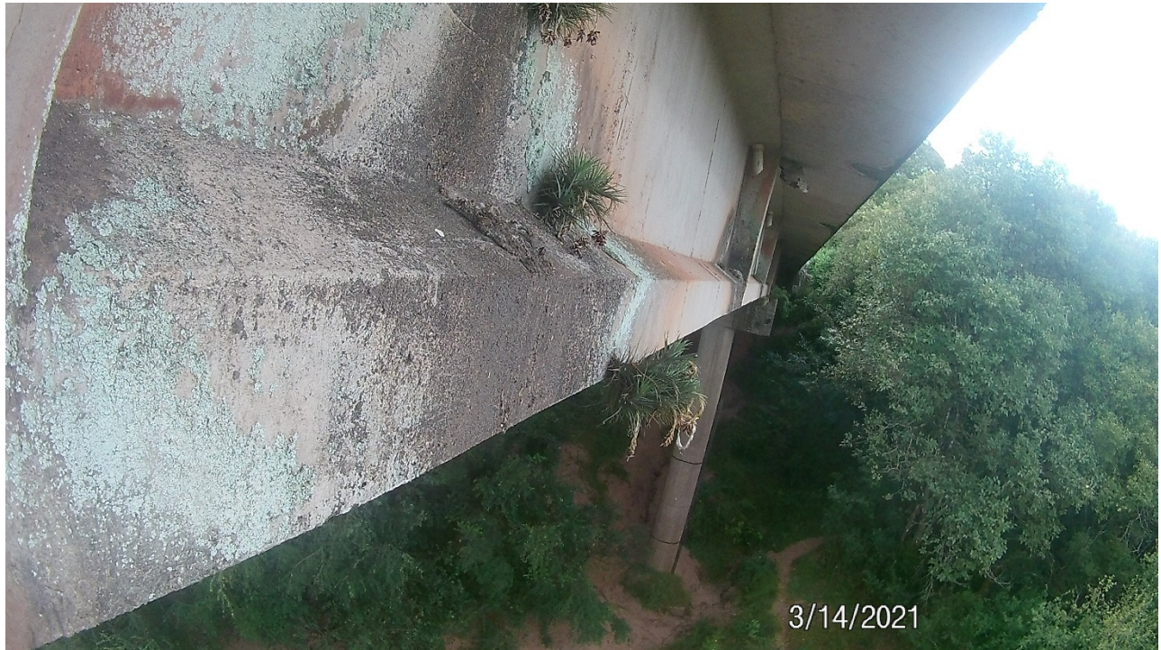
Figura 126 - drenos sob as vigas longarinas
