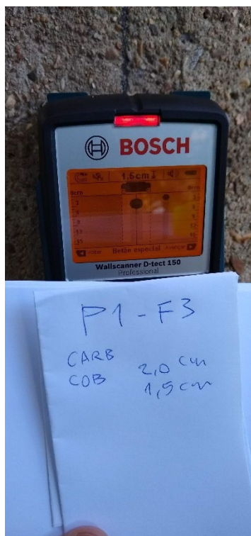
Figura 63 - leitura do cobrimento de concreto P1-F3=1,5cm
