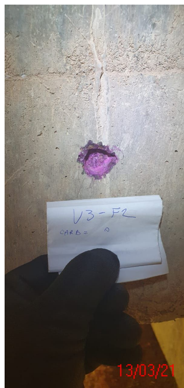
Figura 43 - ensaio de carbonatação V3-F2=0cm
