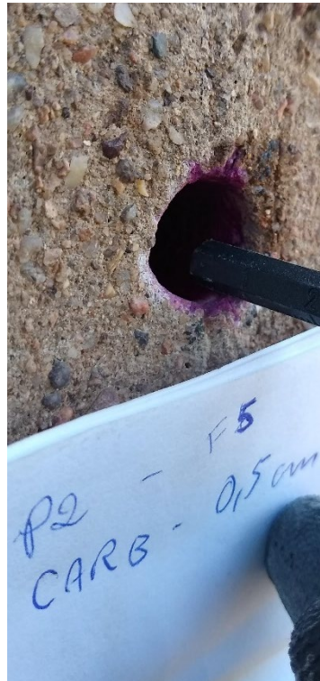
Figura 94 - ensaio da carbonatação P2-F5=0,5cm
