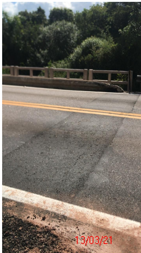
Figura 132 - não identificadas juntas de dilatação na faixa de rolamento
