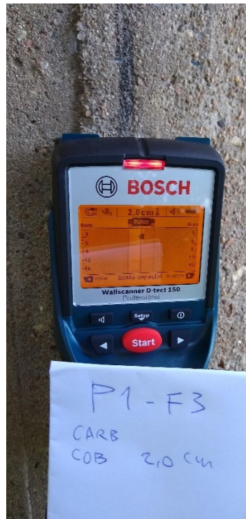
Figura 62 - leitura do cobrimento de concreto P1-F3=2,0cm
