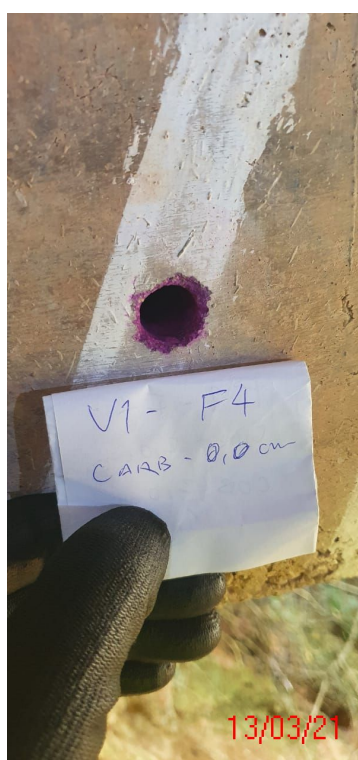
Figura 25 - ensaio de carbonatação V1-F4=0cm
