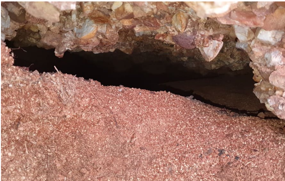
Figura 107 - oco abaixo da laje de transição 1
