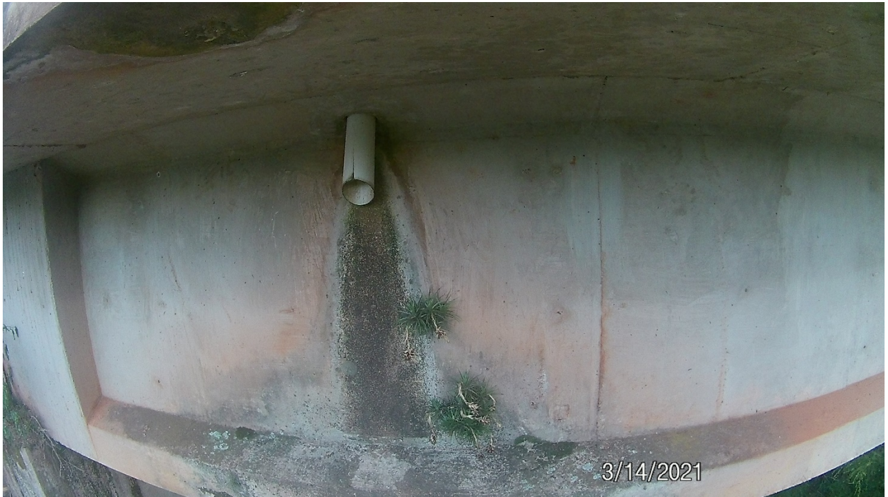
Figura 128 - drenos sob as vigas longarinas
