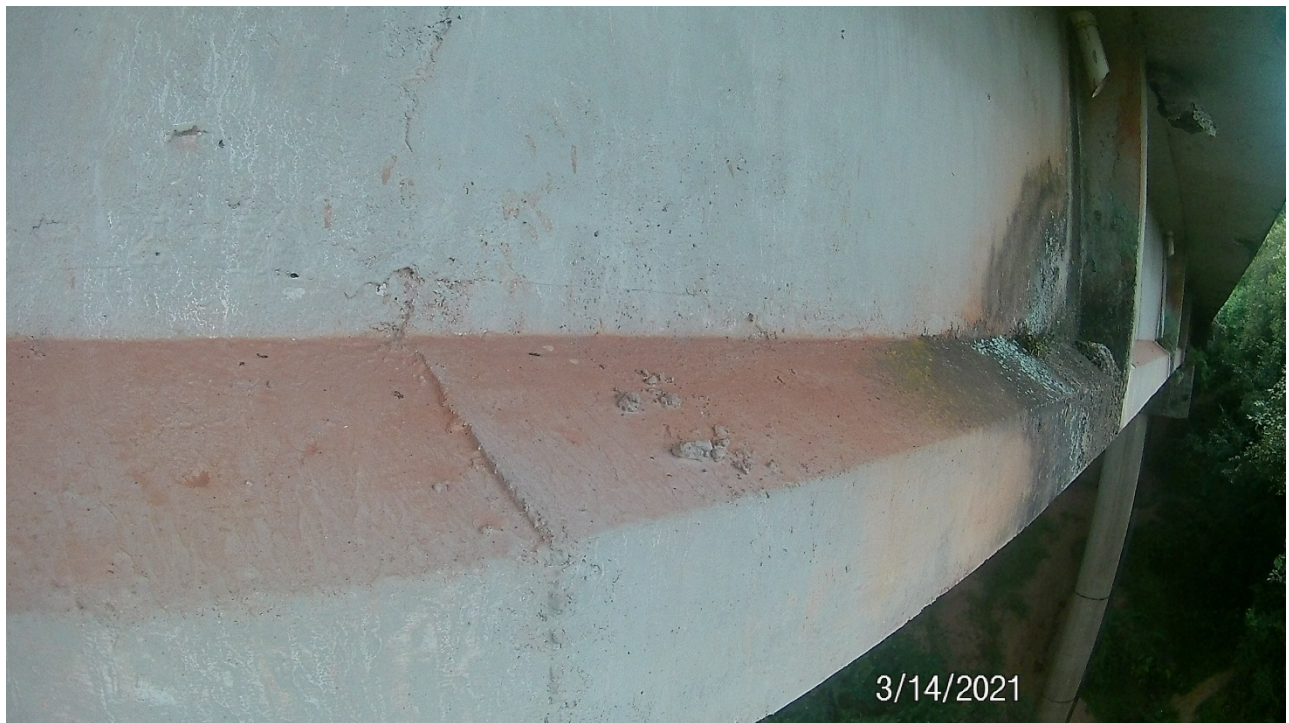
Figura 125 - drenos sob as vigas longarinas
