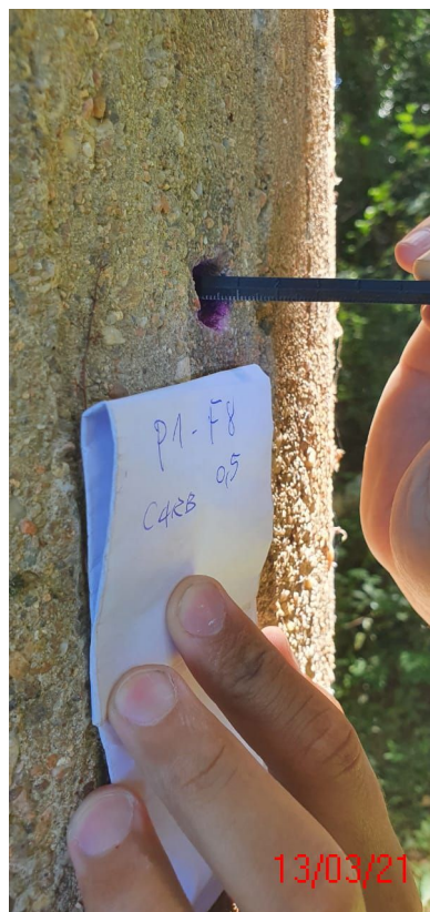
Figura 79 - ensaio da carbonatação P1-F8=0,5cm
