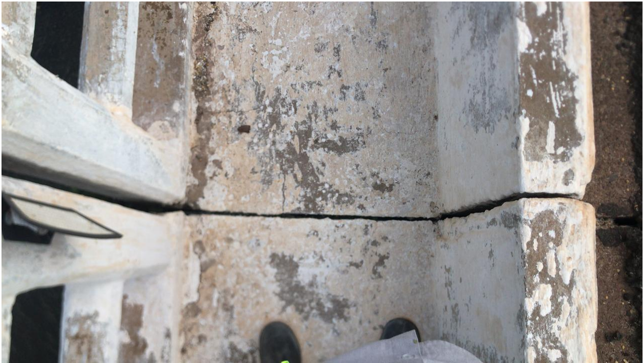
Figura 139 - não identificadas juntas de dilatação no passeio - apoios centrais
