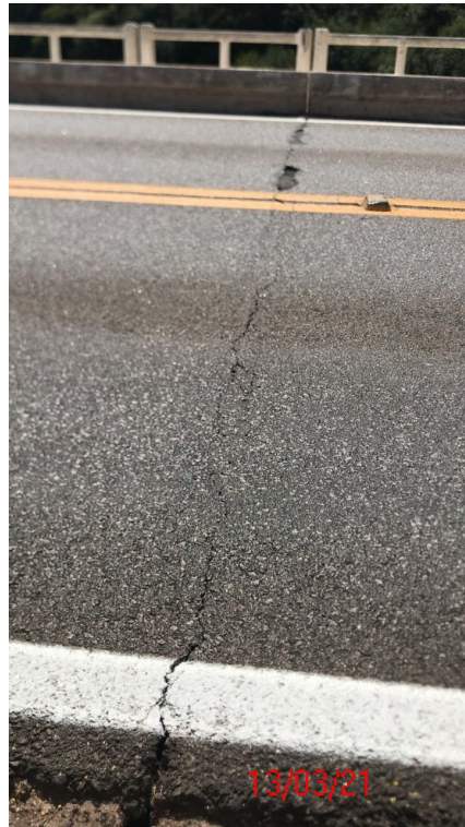
Figura 137 - não identificadas juntas de dilatação na faixa de rolamento - apoios centrais
