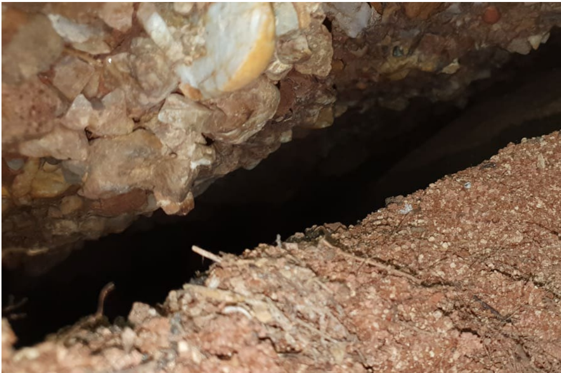
Figura 109 – Identificação de vazio abaixo da laje de transição2
