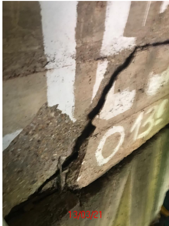
Figura 111 - trecho rompido da cortina de entrada no apoio E01
