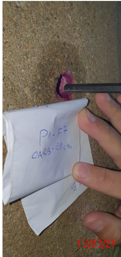
Figura 76 - ensaio da carbonatação do concreto P1-F7=0,5cm
