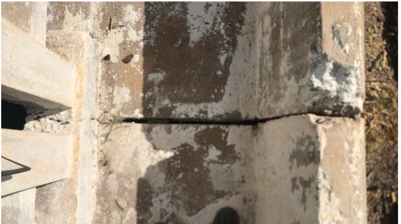
Figura 130 – juntas de dilatação não identificadas
