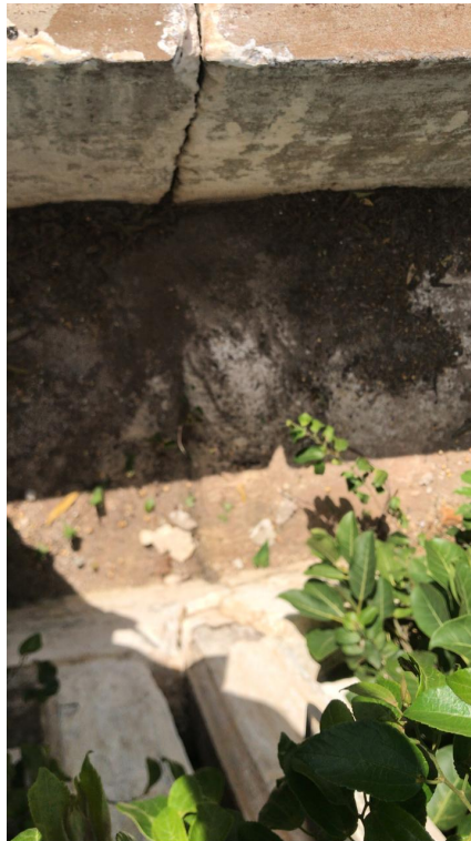
Figura 129 – junta de dilatação sob o passeio não identificadas
