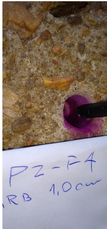
Figura 91 - ensaio da carbonatação P2-F4= 1,0cm
