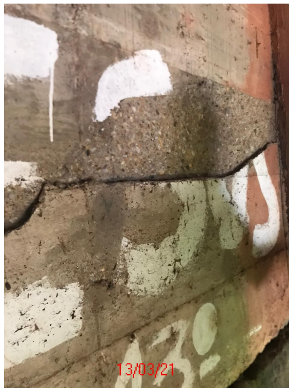
Figura 112 - trecho rompido da cortina de entrada no apoio E01
