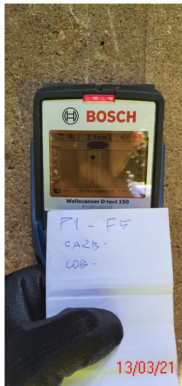
Figura 69 - leitura do cobrimento de concreto P1-F5=2,1cm
