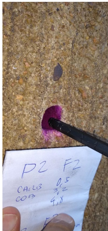
Figura 85 - ensaio da carbonatação P2-F2=0,5cm
