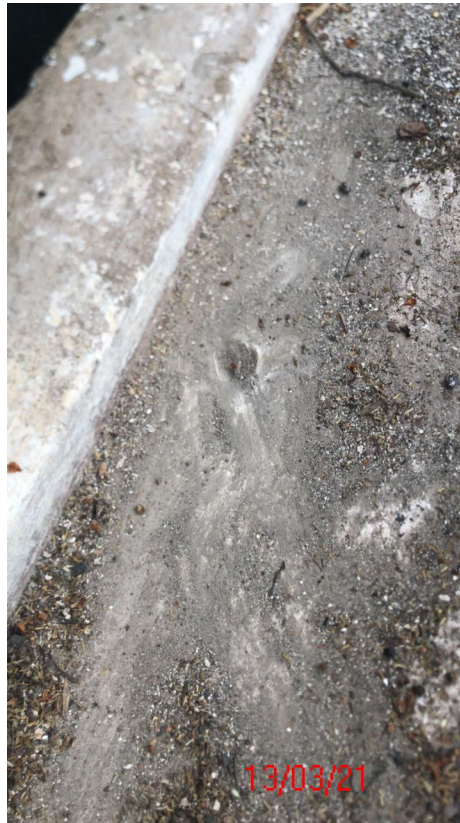
Figura 131 - dreno entupido no passeio
