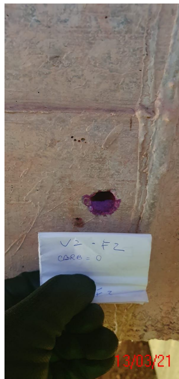
Figura 31 - ensaio de carbonatação V2-F2=0cm
