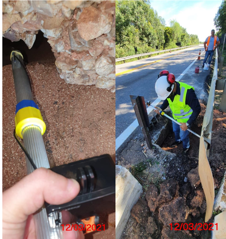
Figura 5 - Ensaio endoscópico para investigação dos vazios sob a laje de transição
